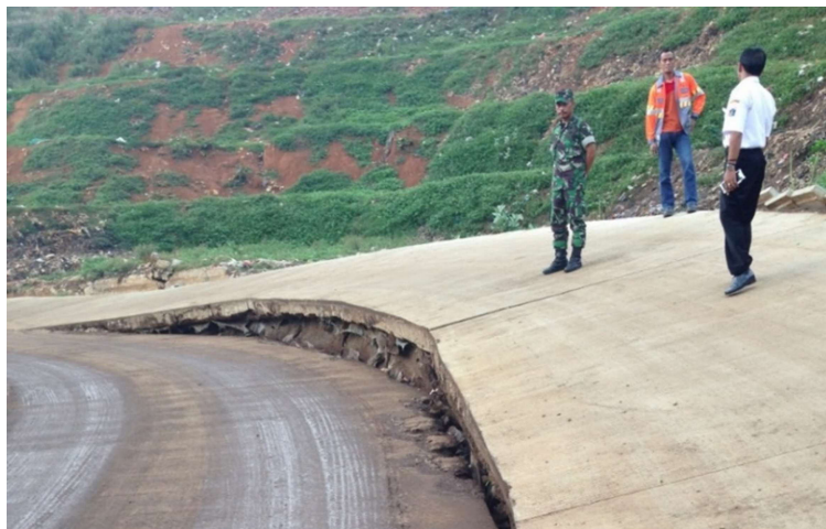
Gambar 1.2 Kondisi Jalan di TPST Bantargebang ( Site Visit, 2018 )
