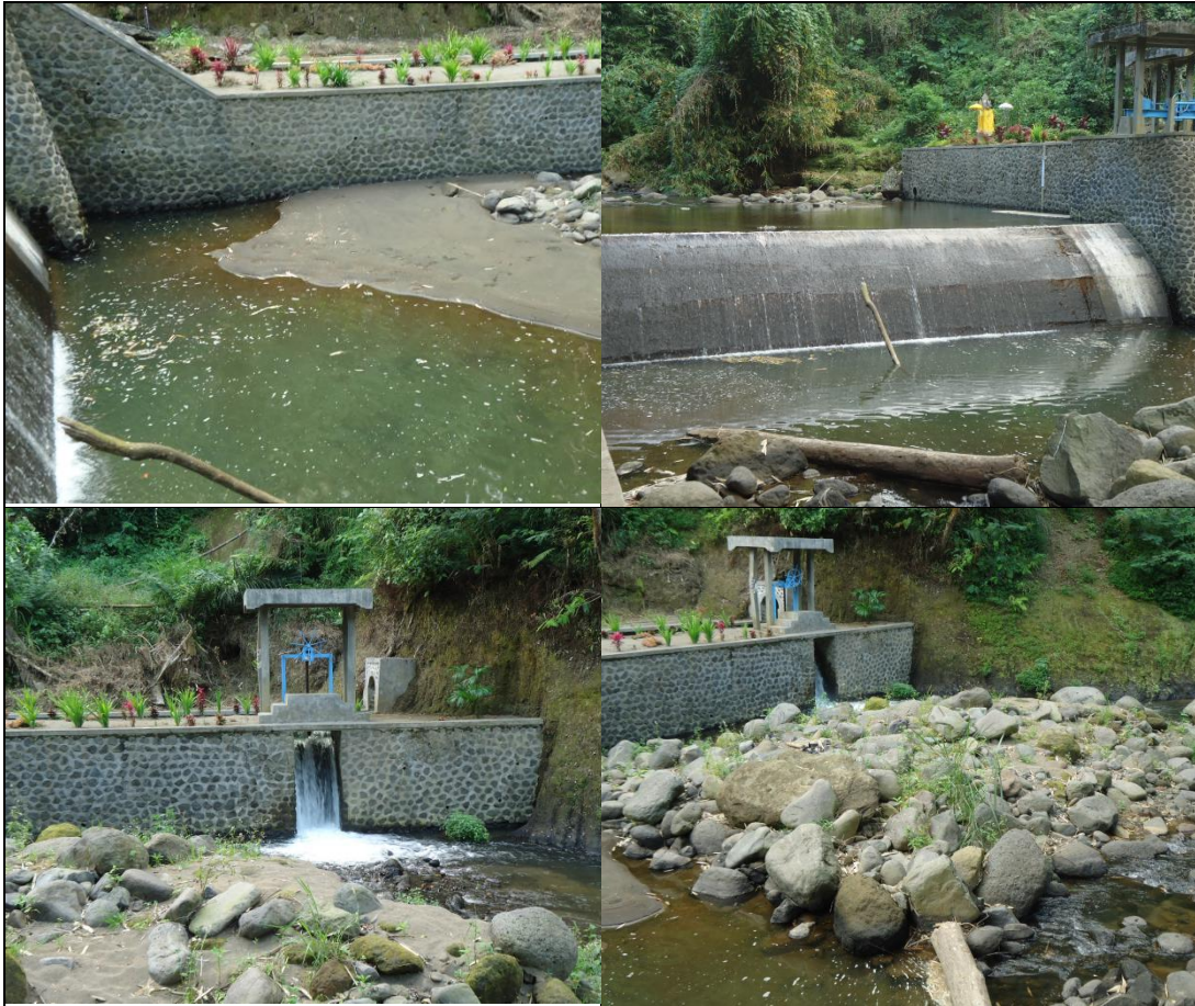
Gambar 1.2 Visualisasi kerusakan kolam olak pada Bendung Pangsut Sari (Sumber: dokumentasi penelitian, 2017)
