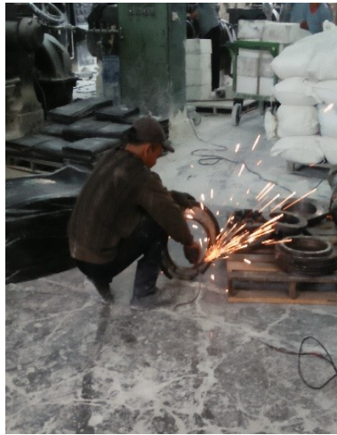
Gambar I.13 Pekerja Mengelas tanpa APD
