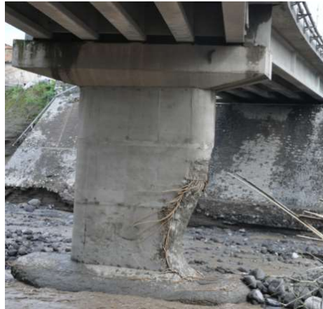
Gambar 1.1 Contoh kerusakan pilar jembatan
