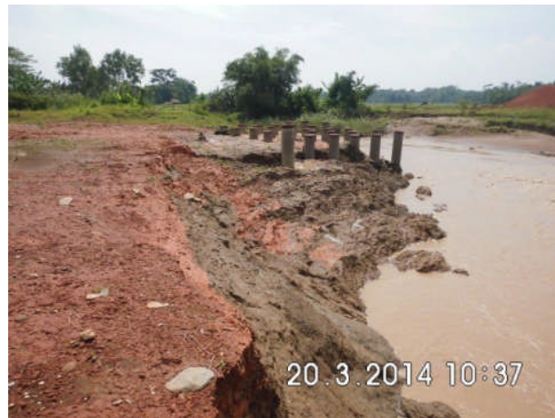
Gambar 1.1. Kondisi Tiang Pancang Mengalami Kegagalan
