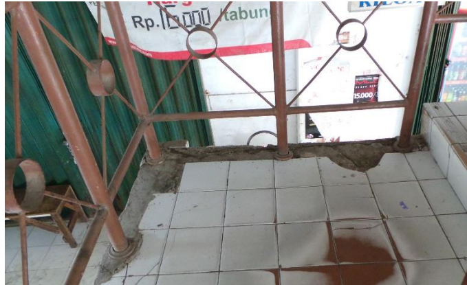
Gambar 5.3 Kerusakan pada Pertemuan Material
