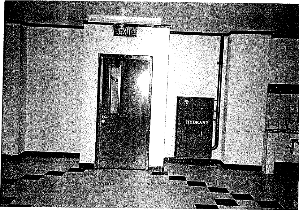
Foto 5 Pintu Darurat dan Hidran
