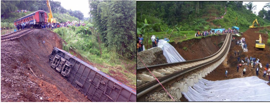
Gambar 15 : Bencana Longsoran pada Hasil Pekerjaan Manusia (kegagalan lereng) di Cibatu, Garut kejadian 21 April 2007 dan di Malangbong, 24 Februari 2009 (sumber : Surono, 2012)
