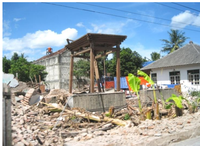
Gambar 10 : Kerusakan bangunan non-engineered dan keutuhan bangunan engineered pada gempa di Yogyakarta 26 Mei 2006 (foto dokumentasi Rahardjo, P.P.)
