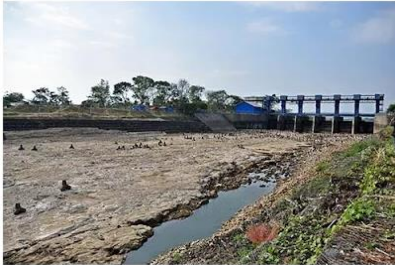
Gambar 1.1 Kekeringan Bendung Manganti
