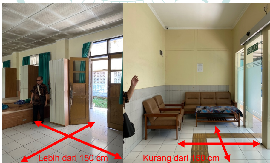
Gambar 5.31 Kondisi Pintu Bangunan Sentra
