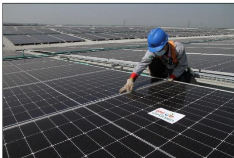
Gambar 1. 1. Pemasangan Panel Surya di Kawasan Pabrik Kalbe (Sumber : bni.co.id)
