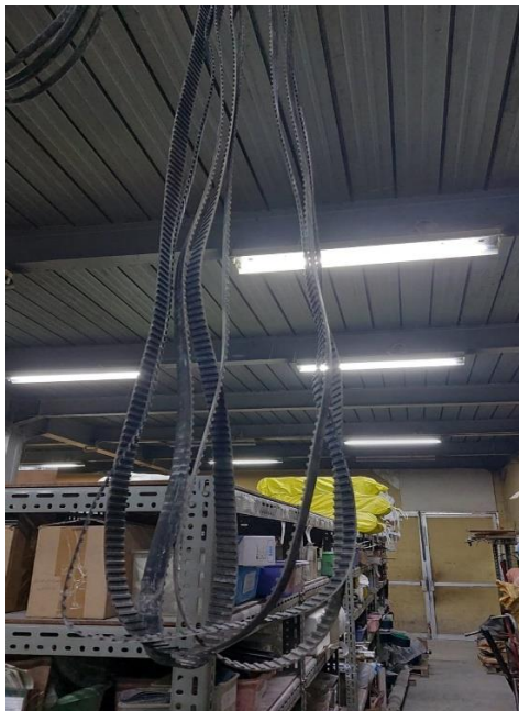
Gambar I. 6 Van Belt yang Menggantung dan Menghalangi
