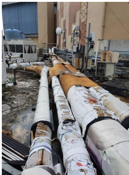
Gambar I.6 Pipa Header Utama
