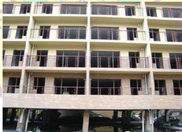
Gambar 1.2 Kegagalan soft story pada lantai dasar di Dujiangyan (Sumber: Wibowo, et al., 2008)
