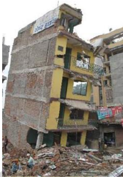
Gambar 1.1 Keruntuhan gedung dengan kondisi soft story akibat gempa Nepal (Sumber: Varum, et al., 2017)
