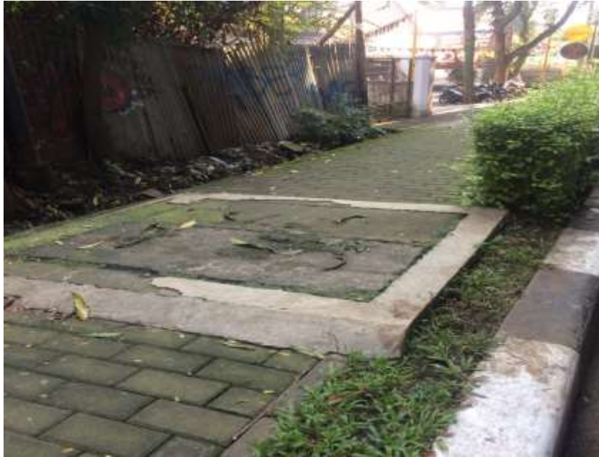
Gambar 1.1 Akses saluran air yang mengganggu mobilitas bagi penyandang disabilitas
