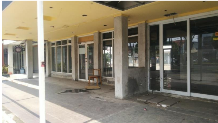
Gambar 1.3 Kondisi tenant yang telah kosong dan tak terawat
