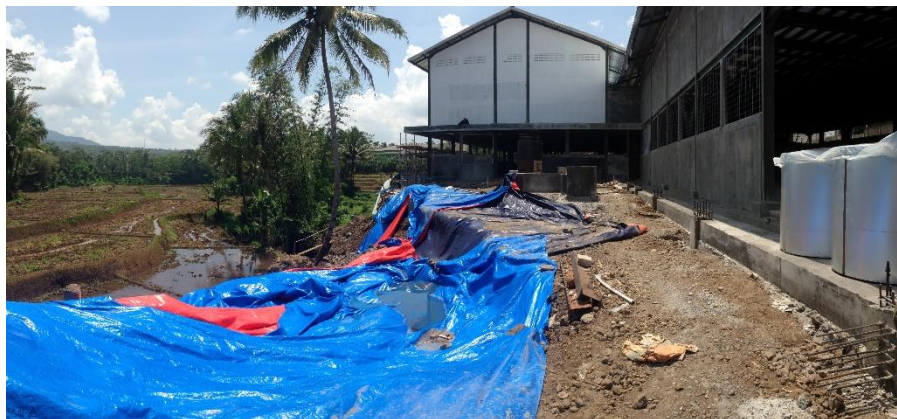
Gambar 1.1 Kondisi lapangan sesudah terjadi kegagalan konstruksi
